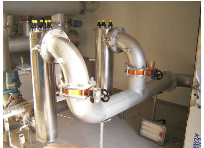
Zwei UV-Entkeimungsanlage à je 1000 l/min
