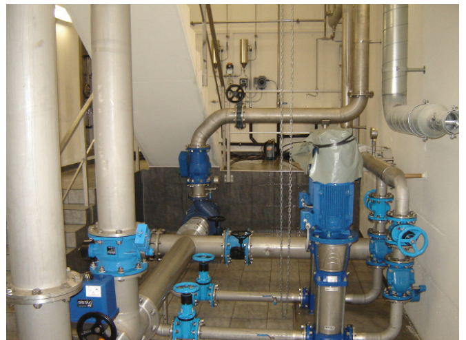
Rohrkeller mit Pumpen
