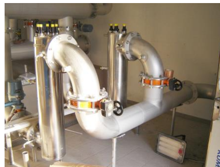
Zwei UV-Entkeimungsanlage à je 1000 l/min
