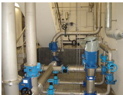
Rohrkeller mit Pumpen
